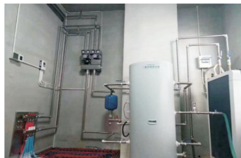
全屋自来水净化器管道系统
