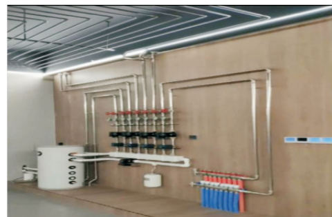
全屋空调管道系统
